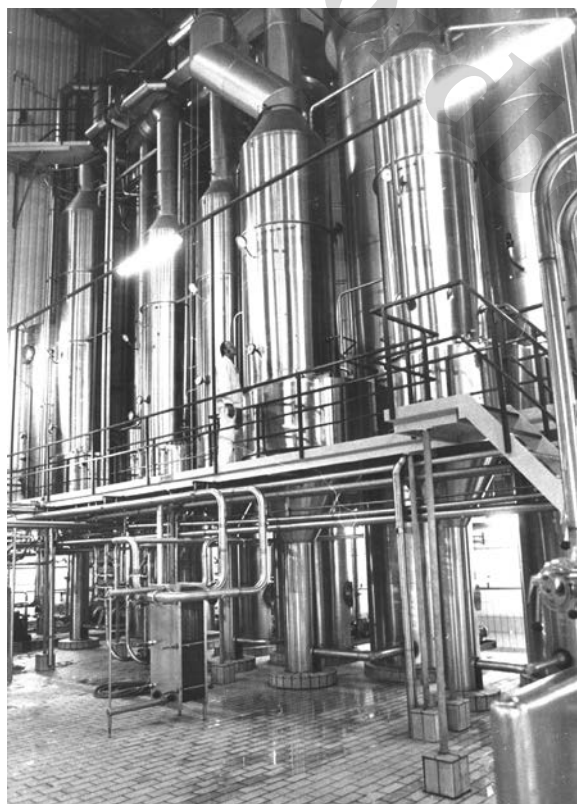
Indampinstallatie De Goede Verwachting Workum, 1979.
